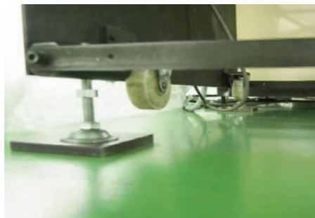
水平を確保する為に、調整器具を要していた
