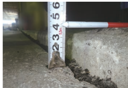
地震の影響で段差が生じてしまった倉庫内
