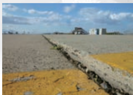
空港エプロンに出来た段差
