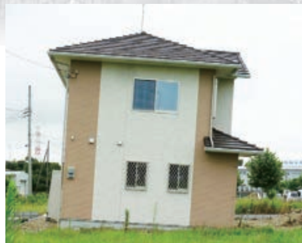
地震による液状化のため大きく沈下してしまった住宅
