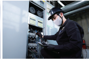
電気系統の修理対応
