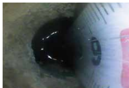
施工前50mmあった空隙
