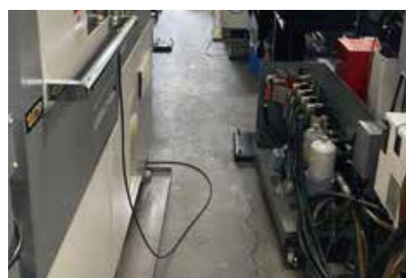
地盤沈下により、土間床にひび・たわみが発生
